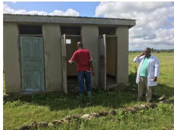
Die kleine Station in Oltukai braucht vor allem einen Wassertank und eine Instandsetzung der Toiletten.
