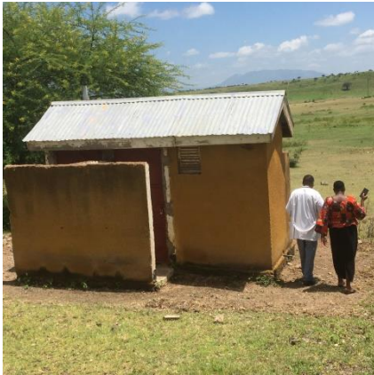
Das alte Toilettengebäude steht in Selela wegen Baufälligkeit leer.
