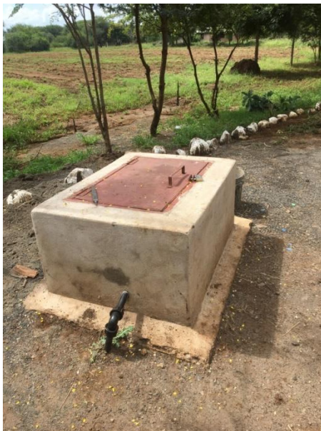
Wasserpunkt und elektrische Pumpe.
