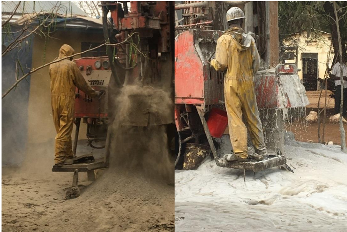
Die Bohrung endete schließlich bei 150 Metern. Zwar traf der Bohrstab schon früher auf Wasser, es wurde aber bis zur optimalen Stelle weiter gebohrt. Mit dem „water strike“ ist der wichtigste Teil geschafft und alle waren erleichtert und froh, dass Wasser gefunden wurde.
