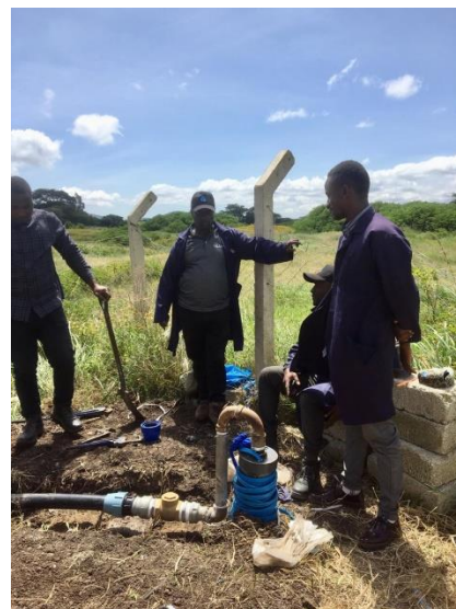
Wasserbehörde und Tandia beim Ortstermin am Pumpenhaus. Bei einem Pumpversuch war eine Verbindung geborsten und musste erneuert werden.
